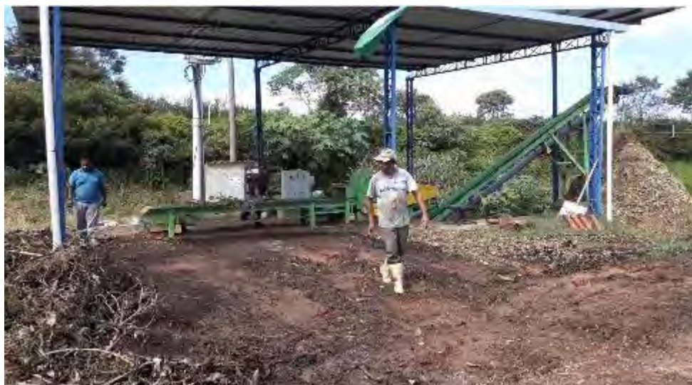
Foto 14 - Instalação para picotamento de madeira no Complexo Ambiental de Socorro.
